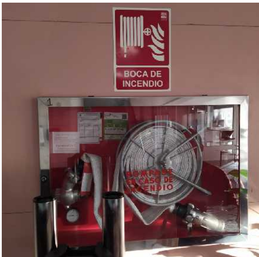
Ilustración 3 BIE de 45mm instalada en el interior del edificio
