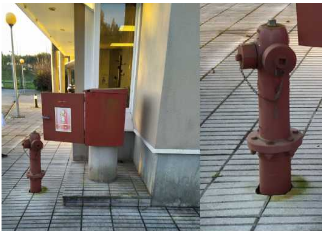
Ilustración 9 Hidrante existente. Ubicación Esquina Noreste
