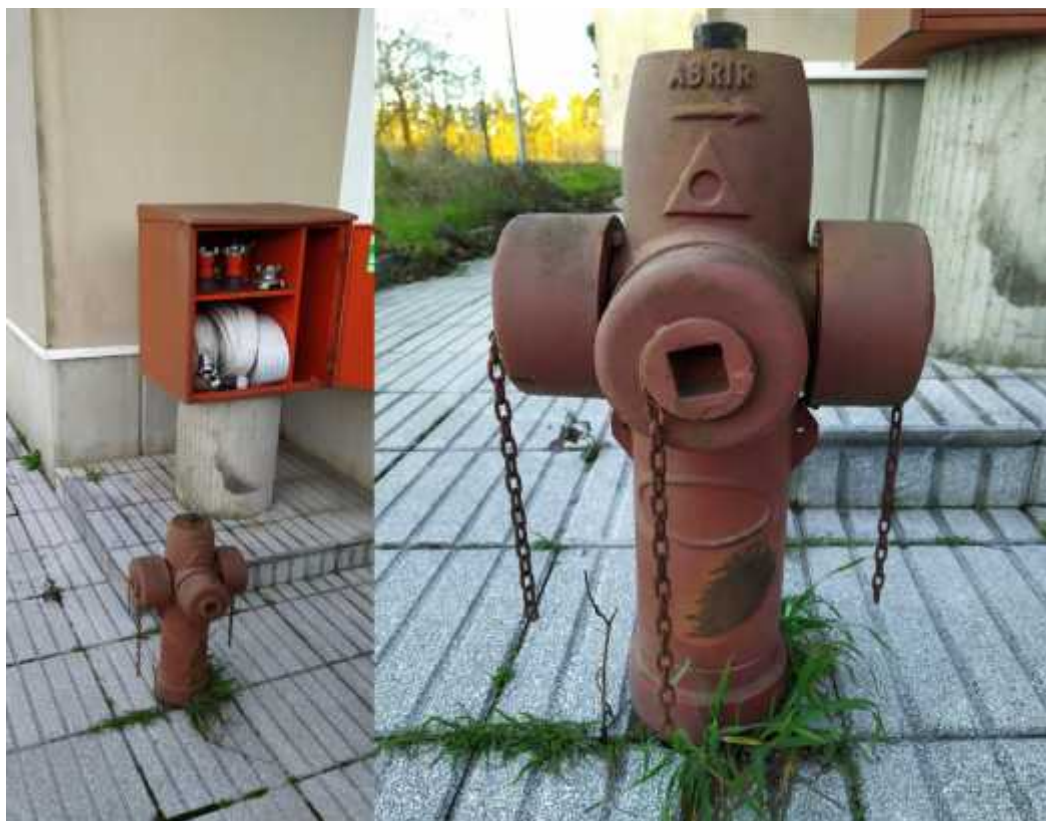
Ilustración 7 Hidrante existente. Ubicación Esquina Sureste
