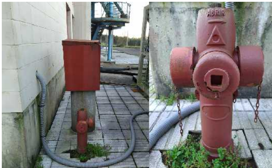
Ilustración 8 Hidrante existente. Ubicación Esquina Noroeste
