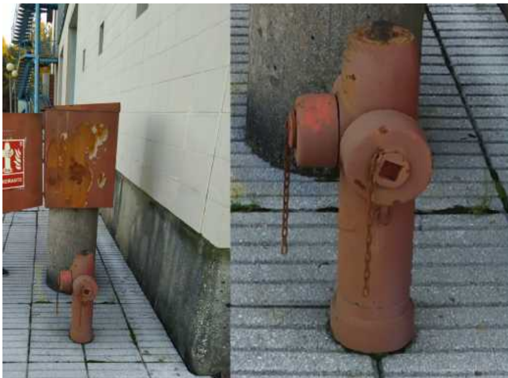
Ilustración 6 Hidrante existente. Ubicación Esquina Suroeste
