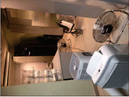
SALA DE EQUIPOS
