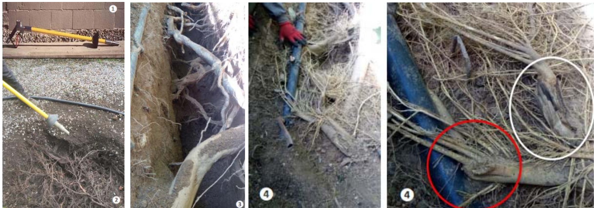
1-Lanza aire a presión; 2-Limpieza raíces; 3-Zanja para obra; 4- Valoración daños raíces
