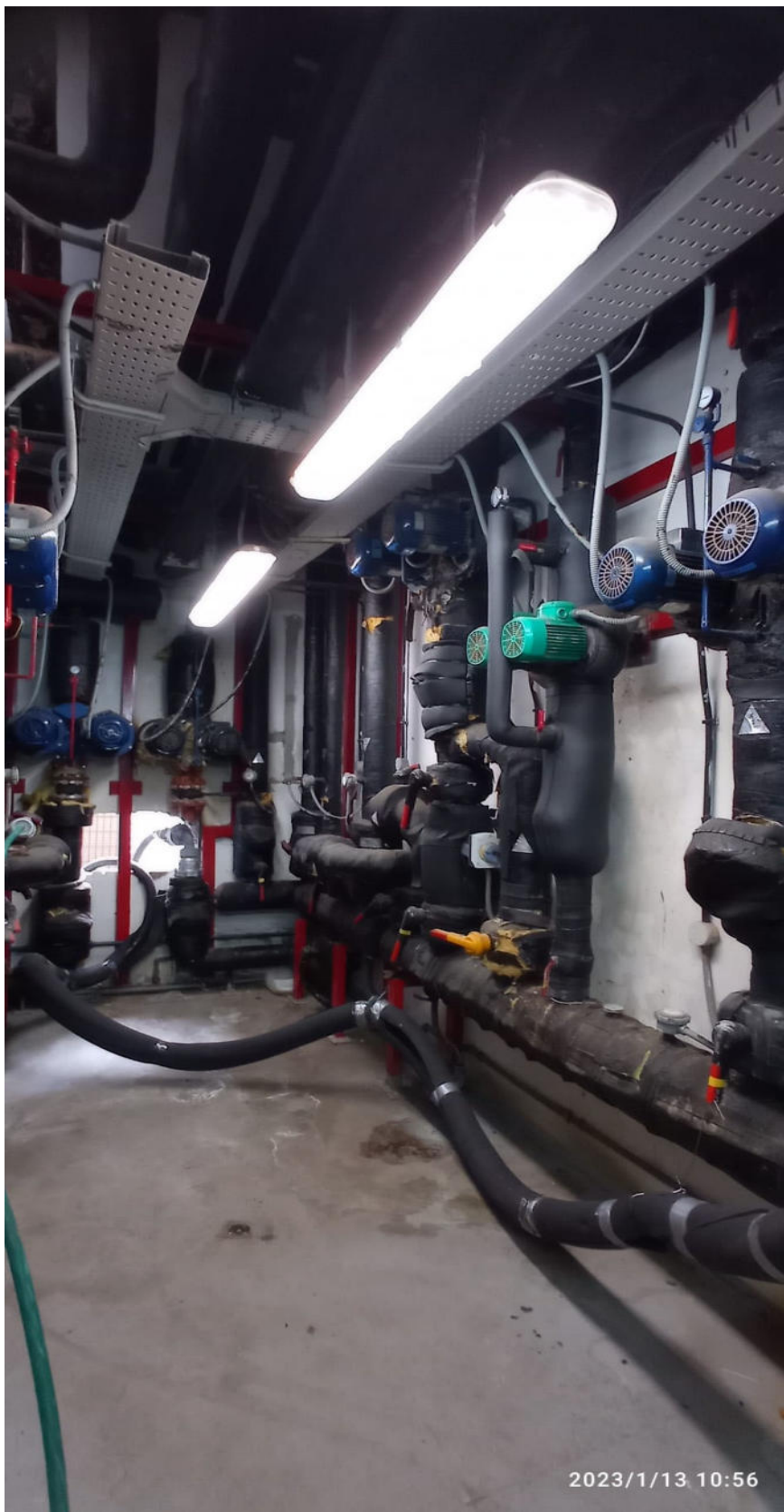
Foto 5 CONEXIONES PROVISIONALES A ENFRIADORA
