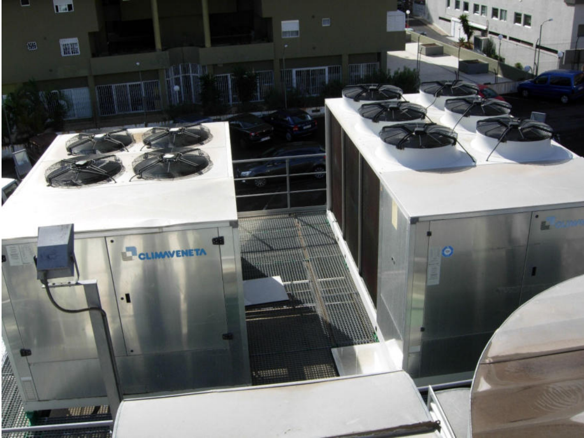
Foto 1 ENFRIADORAS EN DESUSO
