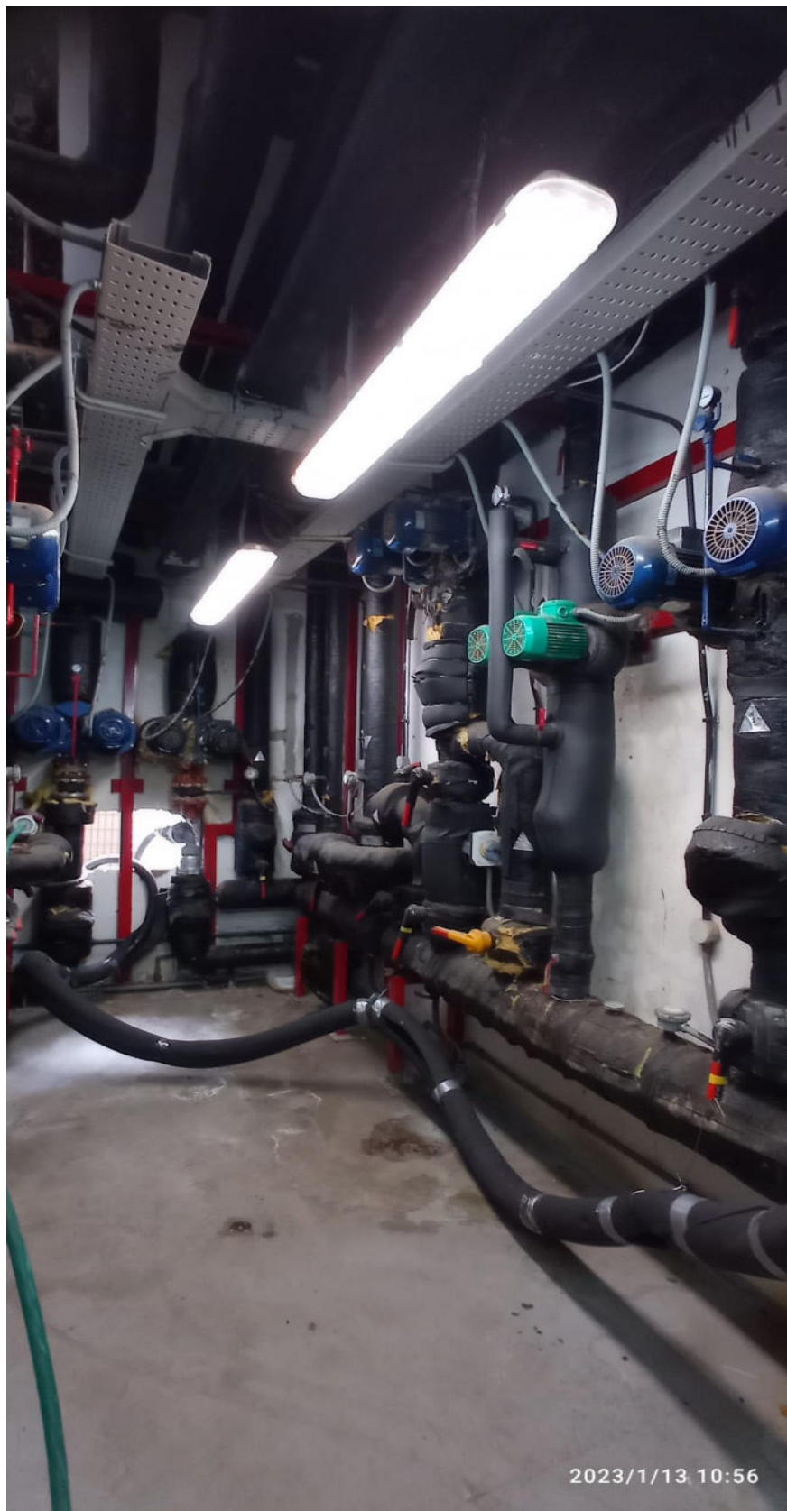
Foto 5 CONEXIONES PROVISIONALES A ENFRIADORA
