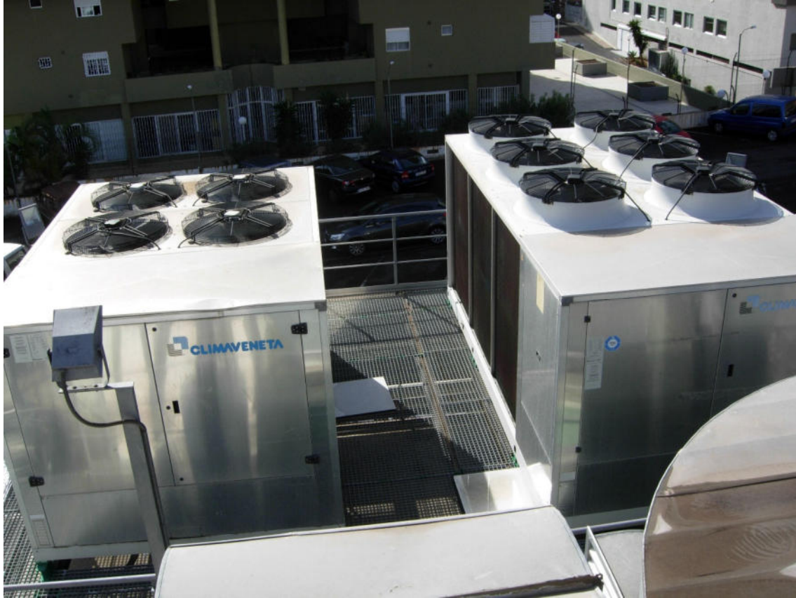
Foto 1 ENFRIADORAS EN DESUSO
