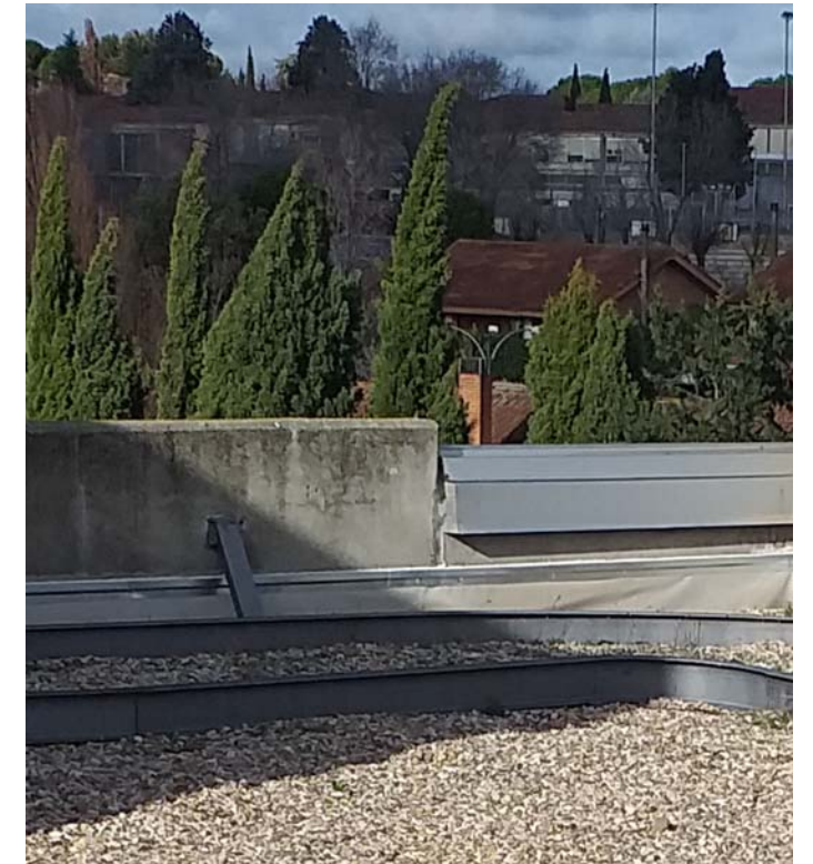
1. SELLADO DETERIORADO. ENCUENTRO PETO DE FACHADA CON PETO DE HORMIGÓN.
