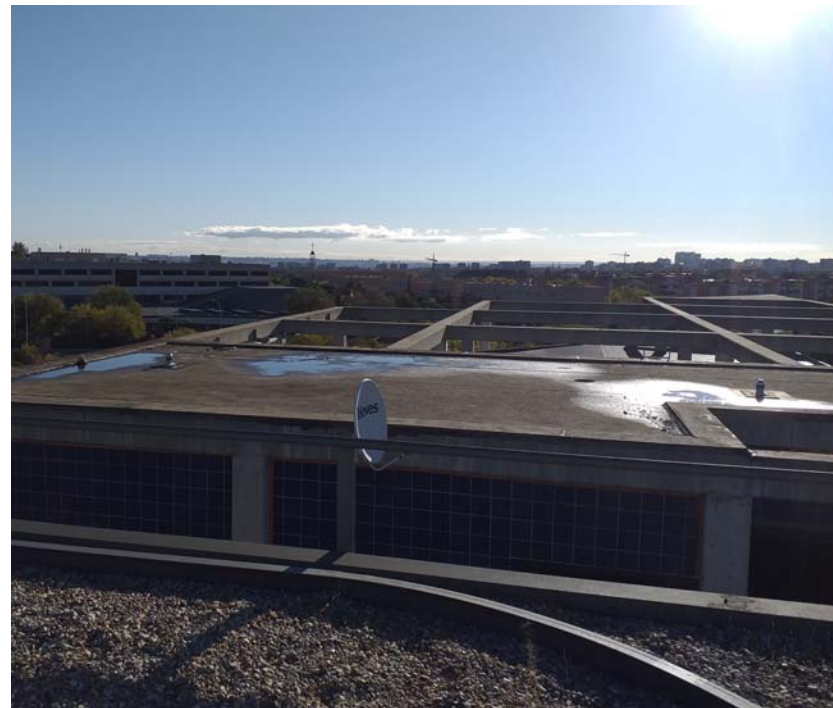
10. AGUA ACUMULADA EN CUBIERTA.
