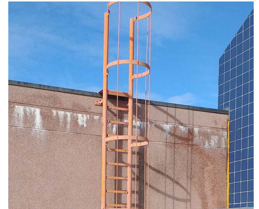
9. EFLORESCENCIAS EN FACHADA
