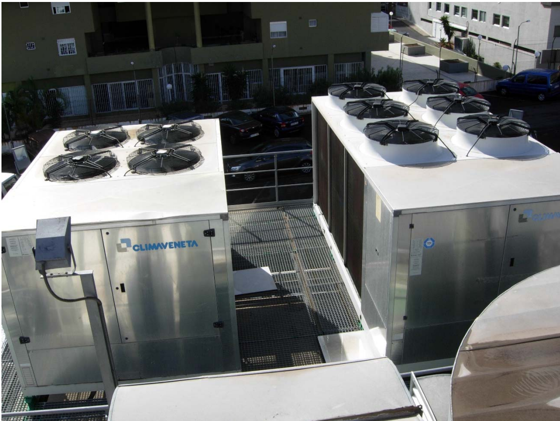
Foto 1 ENFRIADORAS EN DESUSO
