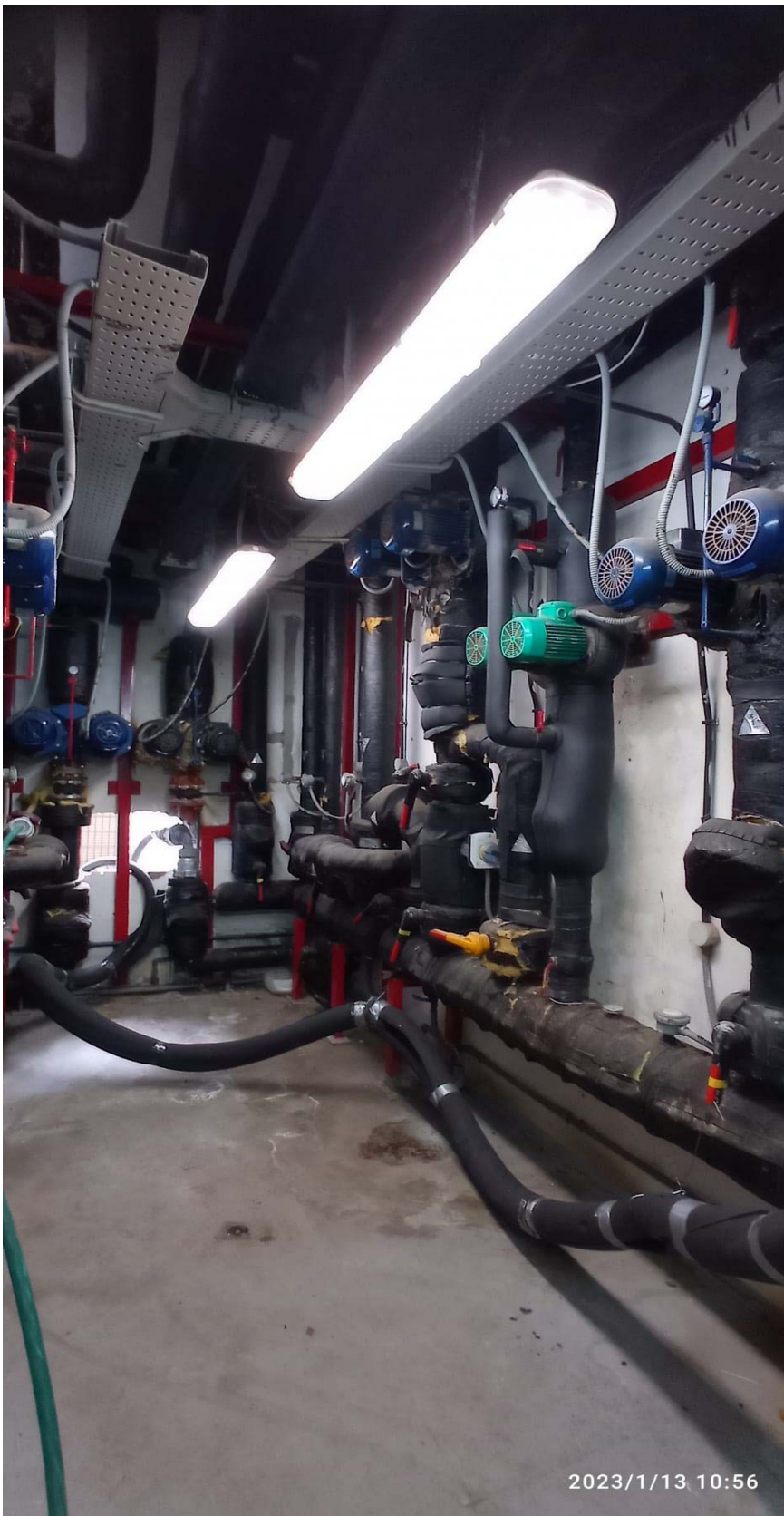
Foto 5 CONEXIONES PROVISIONALES A ENFRIADORA
