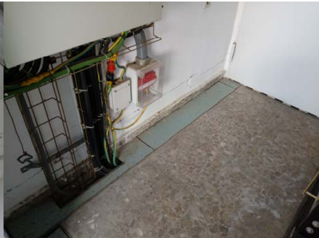
Descuelgue de tabique en solería
