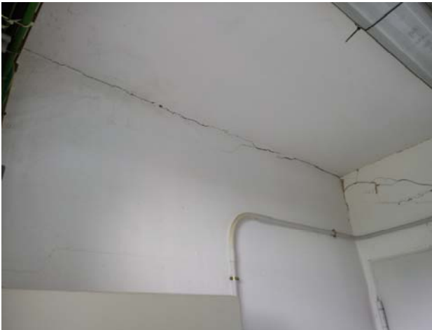
Descuelgue de tabique en el forjado de cubierta
