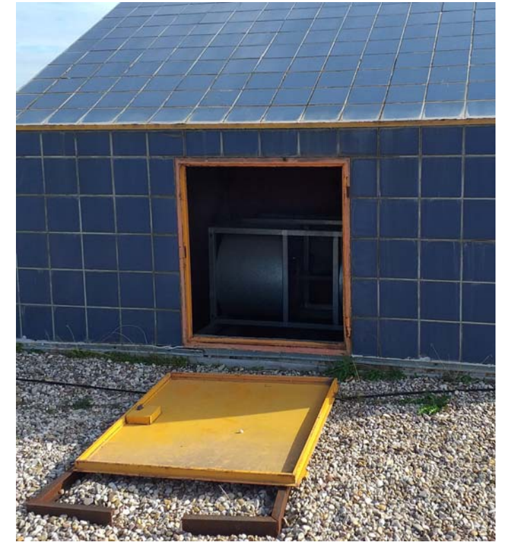
13. PUERTA DE VENTILACIÓN DETERIORADA
