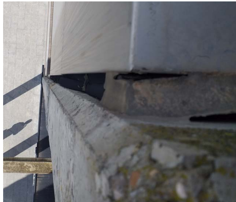
1. SELLADO DETERIORADO. ENCUENTRO PETO DE FACHADA CON PETO DE HORMIGÓN.
