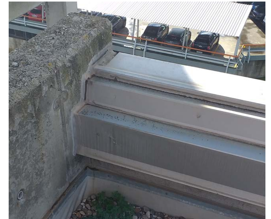
1. SELLADO DETERIORADO. ENCUENTRO PETO DE FACHADA CON PETO DE HORMIGÓN.
