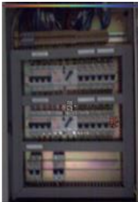
CUADRO MUELLE PLANTA -1 PUNTO 16
