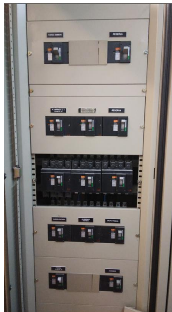
CUADRO GENERAL BAJA TENSIÓN PUNTO 18
