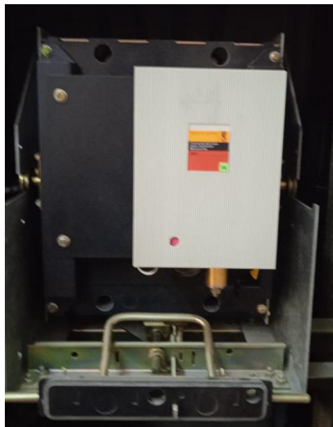
INTERRUPTOR GENERAL PUNTO 19
