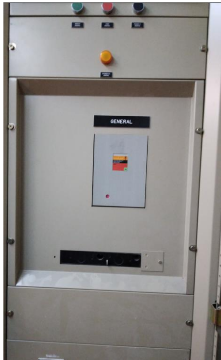
INTERRUPTOR GENERAL PUNTO 19
