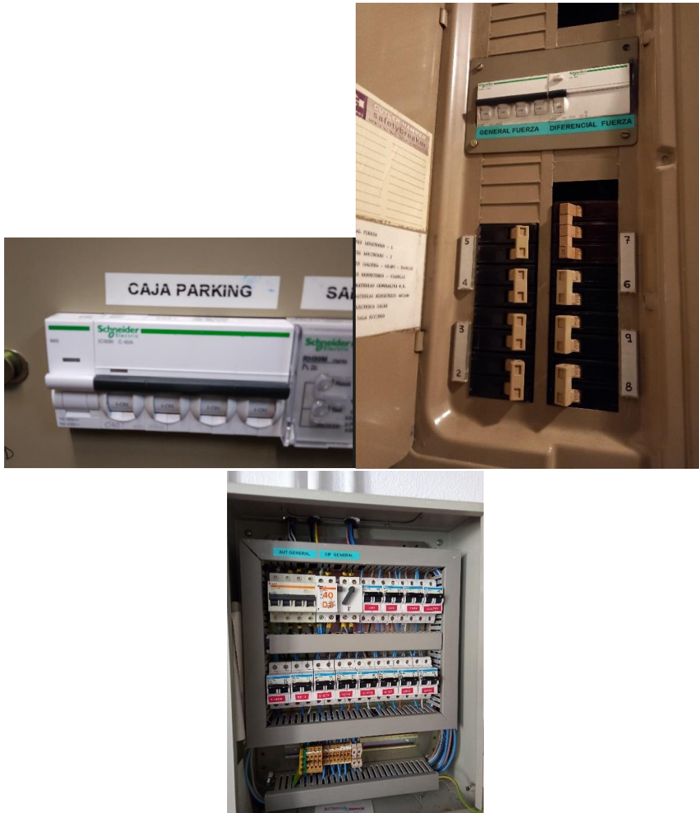
INTERRUPTOR GENERAL DE CUADRO EQUIPOS MÓVILES PUNTO 1
