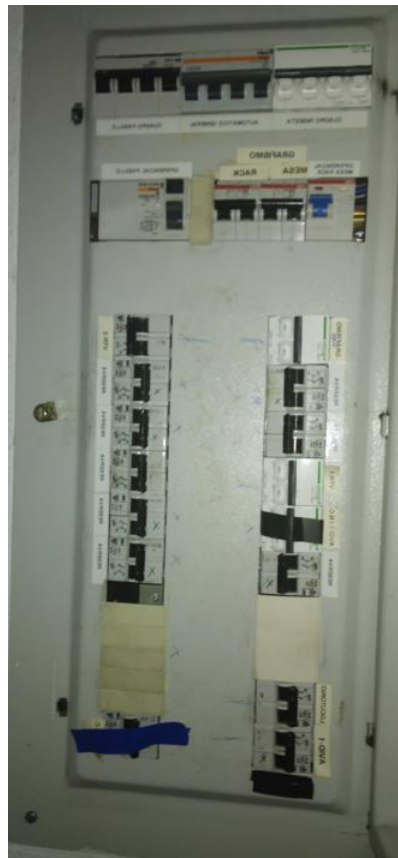
CUADRO EN PASILLO CENTRAL PUNTO 3
