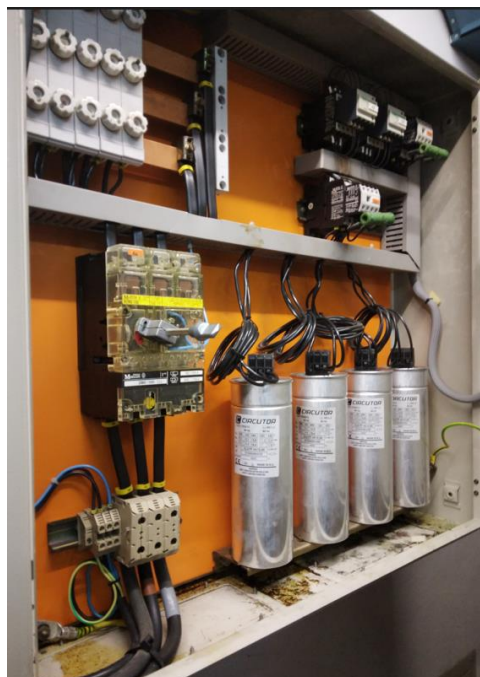
CUADRO BATERÍA DE CONDENSADORES PUNTOS 4 Y 5
