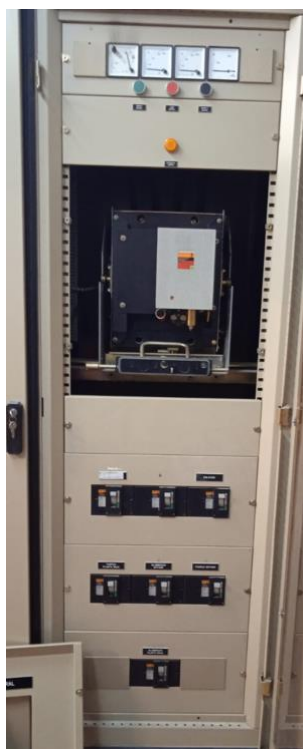
INTERRUPTOR GENERAL PUNTOS 18 Y 19
