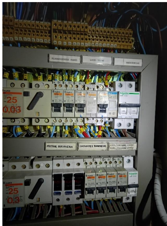
CUADRO ALUMBRADO – FUERZA GRÚA PUNTO 7
