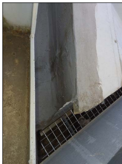
25. CANALÓN CON REJILLA Y CHAPA.
