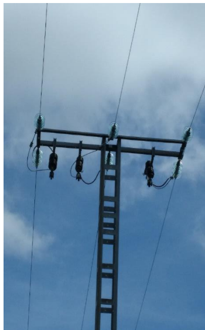
APOYO AMARRE CON CELOSIA
