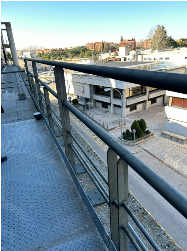
Fotografía 3. Barandilla existente planta 3ª
