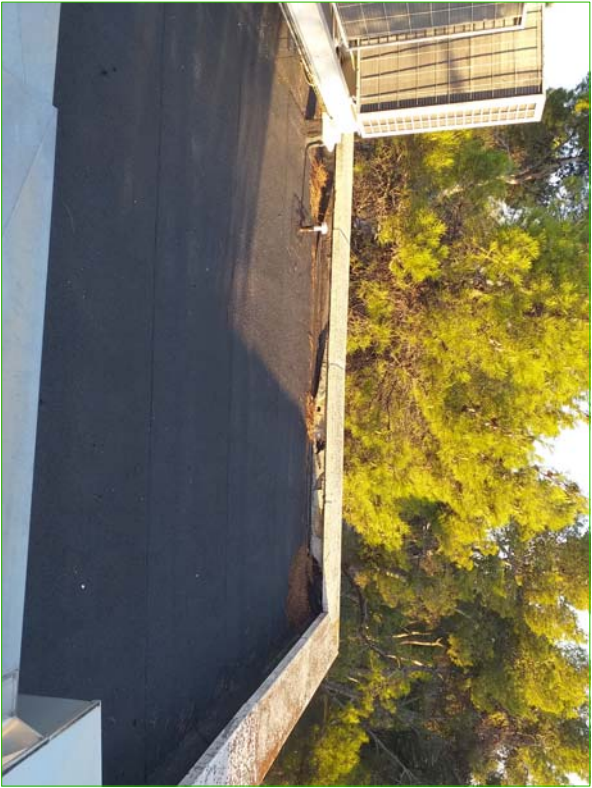
08. DESPRENDIMIENTO DE TELA EN PETO DE CUBIERTA
