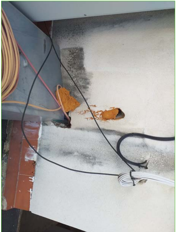
02. HUECO EN PASO DE INSTALACIONES
