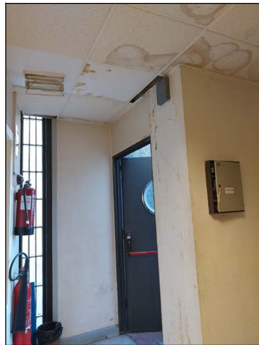
17. GOTERAS EN CUARTO DE SEGURIDAD
