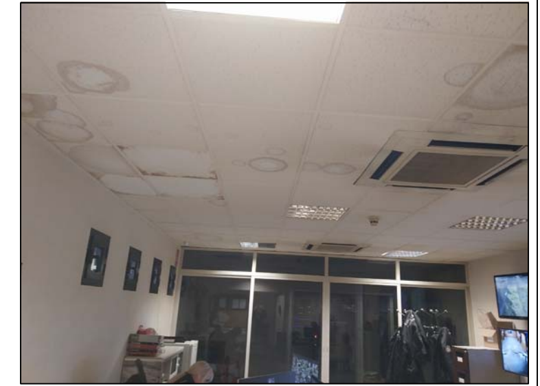
20. GOTERAS EN CUARTO DE SEGURIDAD
