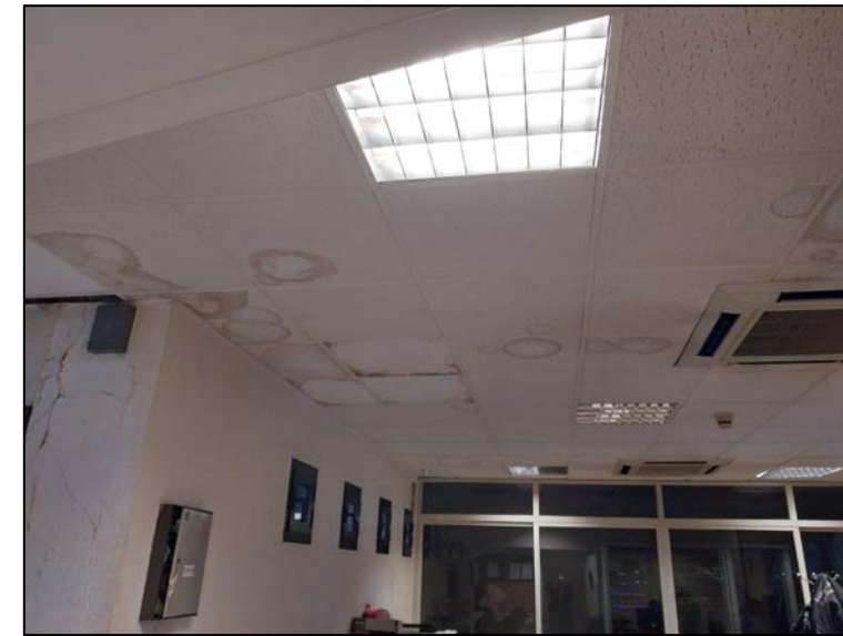
19. GOTERAS EN CUARTO DE SEGURIDAD
