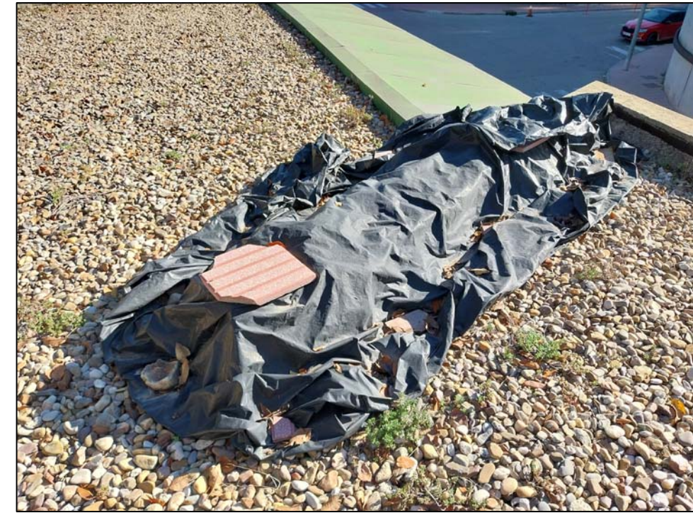
01. ENTRADA DE AGUA EN CUBIERTA EN SU ENCUENTRO CON EL MURO
