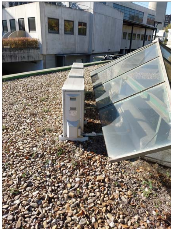
07. EQUIPOS DE CLIMA
