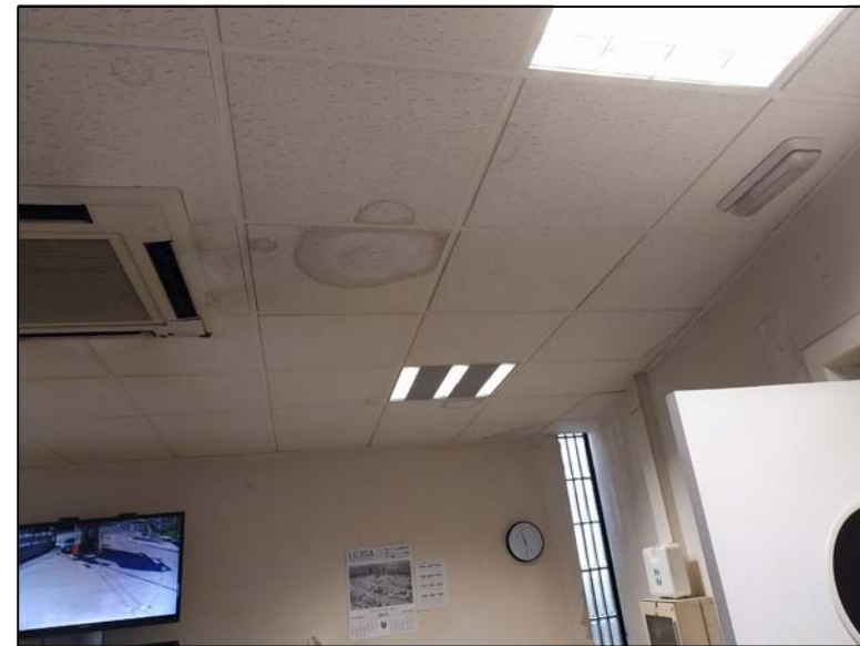
18. GOTERAS EN CUARTO DE SEGURIDAD
