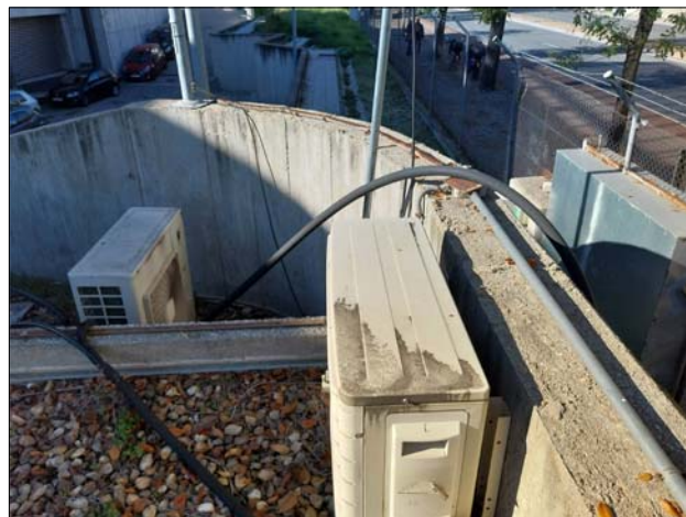
12. UNIDAD EXTERIOR A DESPLAZAR
