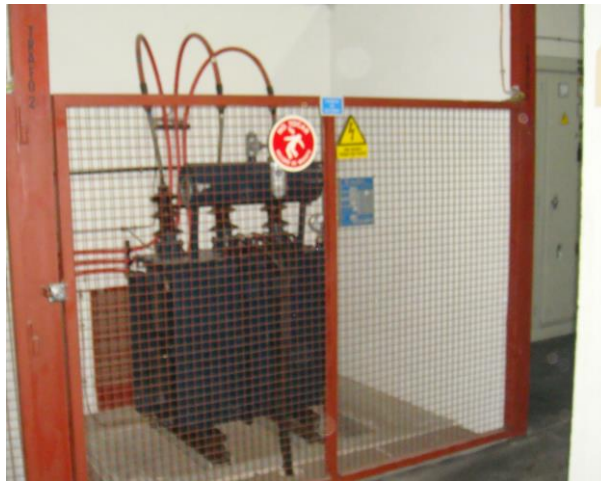
Foto 3 Trafo 3 – 100 kVAs a eliminar
