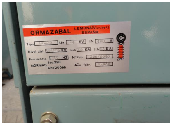
Foto 9 Placa de características de celdas de centro de seccionamiento
