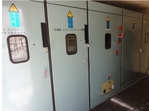
Foto 8 Vista general celdas en centro de seccionamiento
