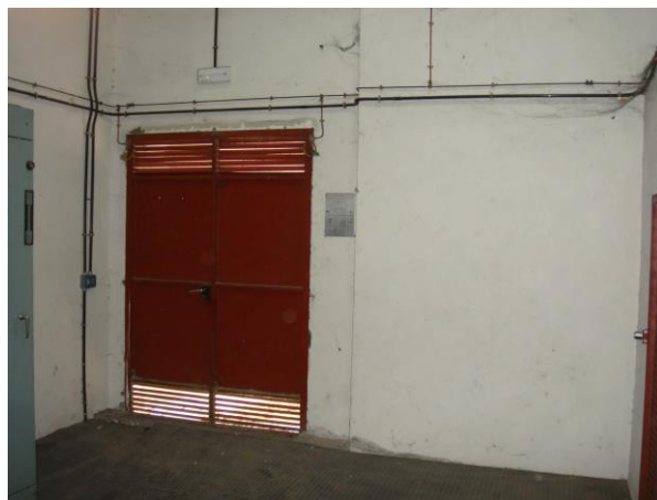
Foto 6 Entrada desde el exterior al Centro de transformación de abonado
