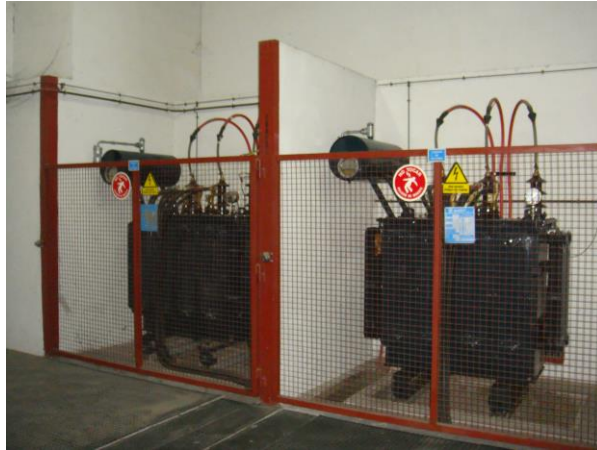
Foto 2 Trafos 1 y 2, existentes a sustituir el trafo 2 y eliminar el trafo 1
