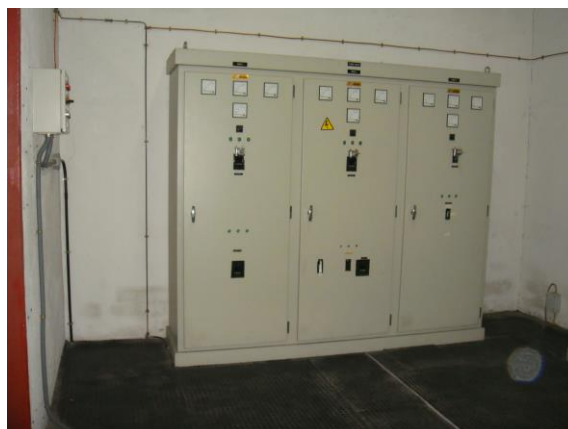
Foto 4 Cuadro de baja tensión salidas trafos
