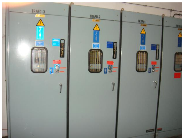
Foto1 Celdas de línea de entrada y de protección de trazo.
