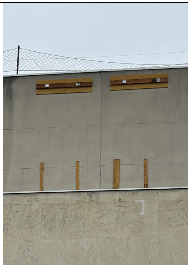
Paño Sur deformado, junta de dilatación vertical en su centro.
