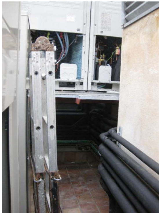
Equipos Daikin RZQ
