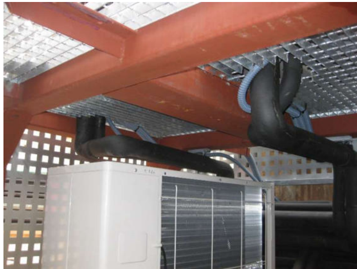
Equipo Panasonic bajo estructura equipos DAIKIN
