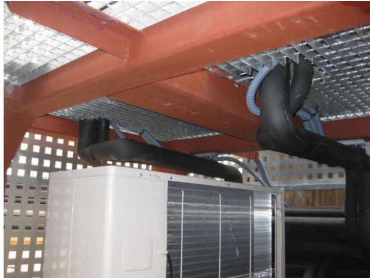
Equipo Panasonic bajo estructura equipos DAIKIN
