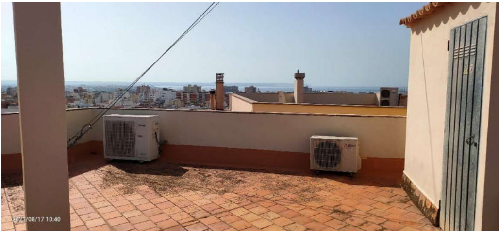
Cubierta, subida futuras tuberías a equipos Daikin desde patio interior principal
