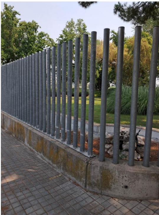
Tipo de vallado a colocar sobre los muros de hormigón del patio.
