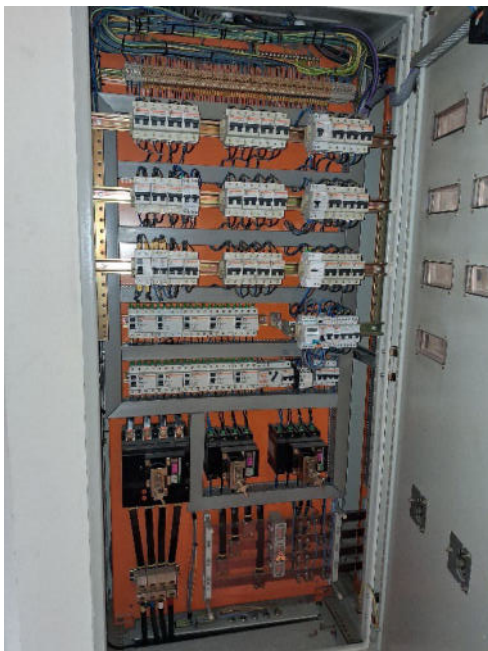
CUADRO ELECTRICO EDIFICIO
