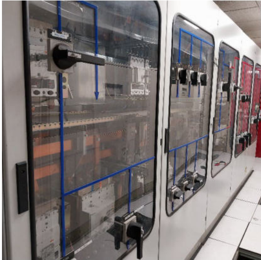
CUADRO ELECTRICO SALA SAIS
