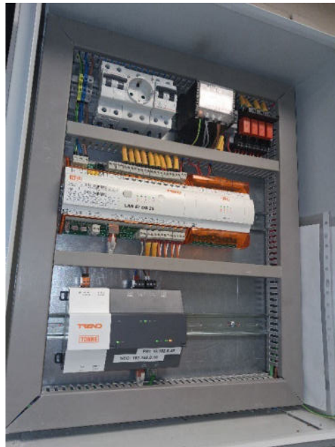
CUADRO CONTROL EDIFICIO
