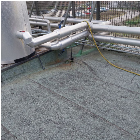
TUBERIAS EN CUBIERTA A CLIMATIZADORES
