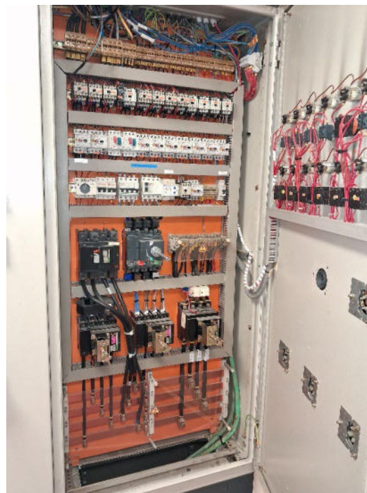
CUADRO ELECTRICO EDIFICIO CLIMATIZACION
