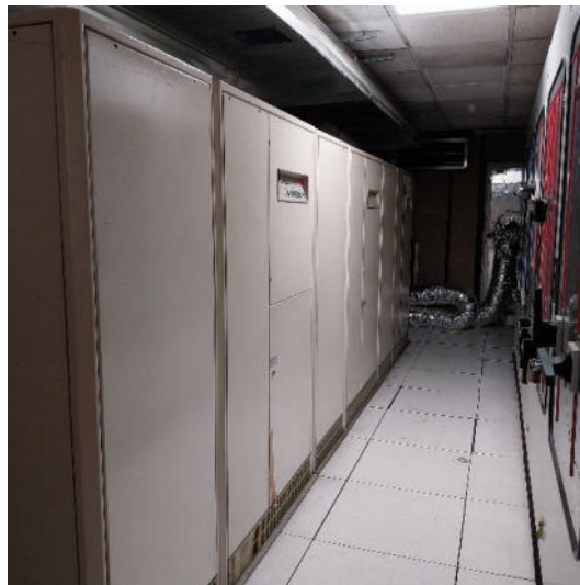
SAIS. PASILLO CUADRO ELECTRICO
