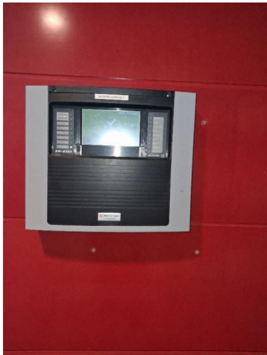
CENTRAL NOTIFIER EDIF CORONA
