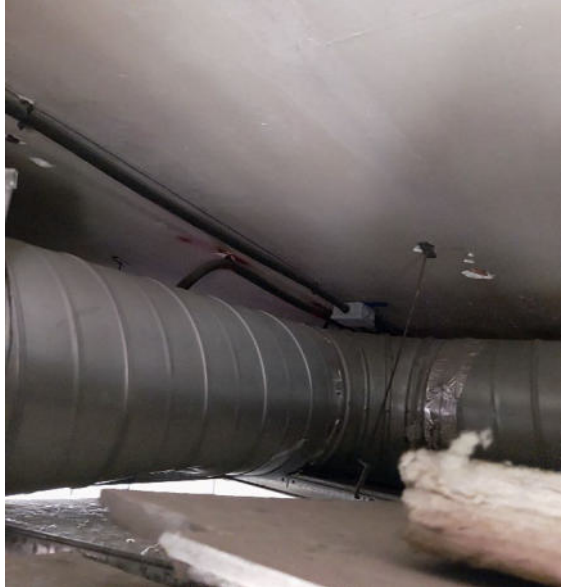
CONDUCTO EXTRACCION CAMPANA EN FT
