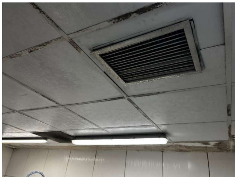
TECHOS DE ZONA DE LAVADO. DETALLE HUMEDADES
