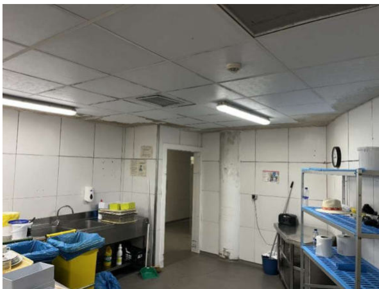
ZONA DE LAVADO
