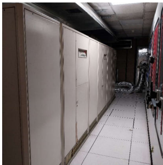
SAIS. PASILLO CUADRO ELECTRICO
