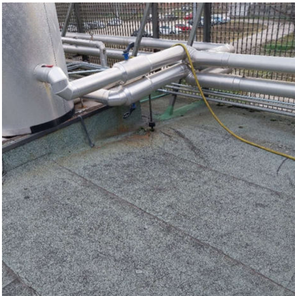
TUBERIAS EN CUBIERTA A CLIMATIZADORES
