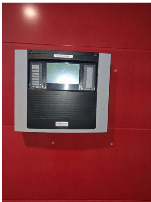
CENTRAL NOTIFIER EDIF CORONA
