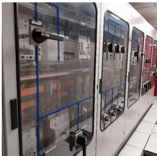
CUADRO ELECTRICO SALA SAIS
