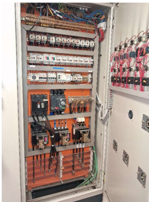
CUADRO ELECTRICO EDIFICIO CLIMATIZACION
