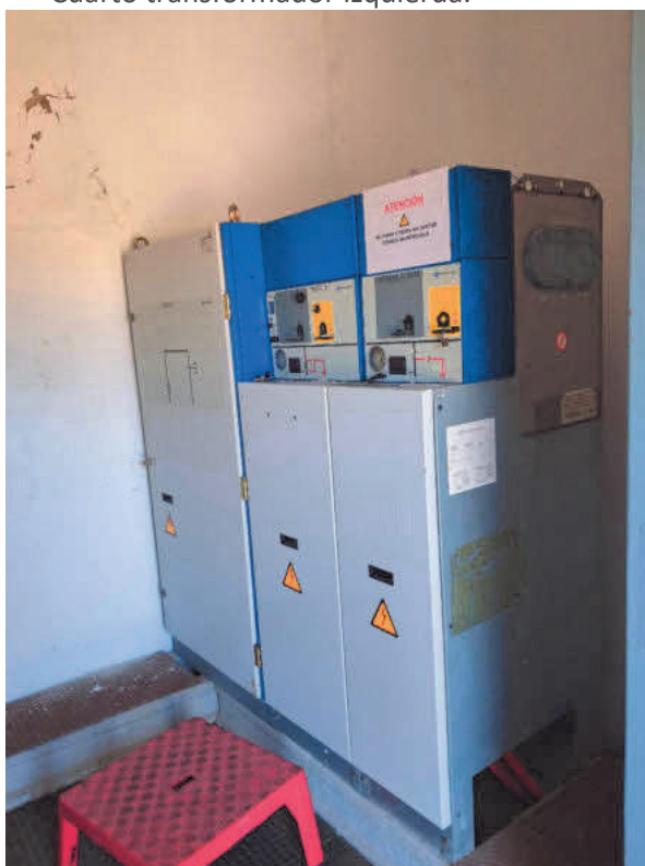
Cuarto transformador derecha.
