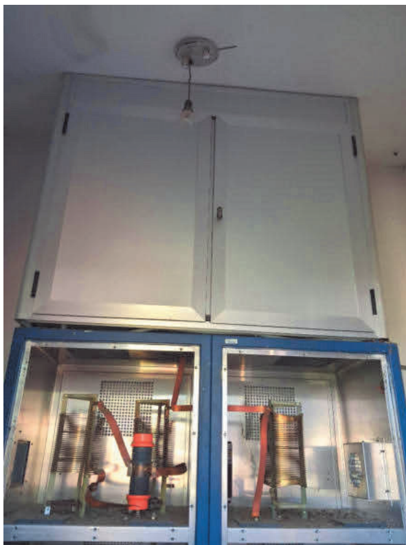
Instalaciones cuarto principal
