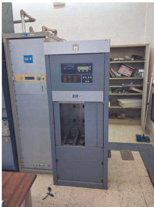
Aparamenta interior edificio
