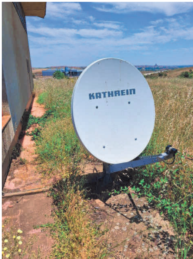
Antena y conexiones.
