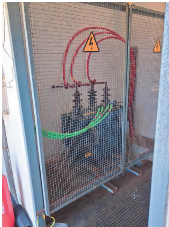
Cuarto transformador izquierda.
