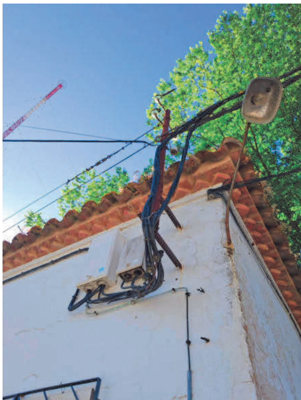
Conexión línea exterior con edificio
