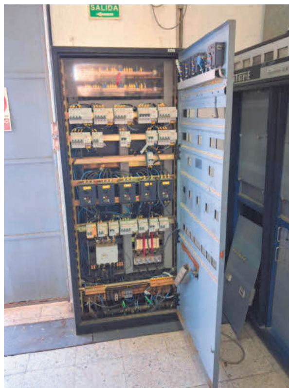
Aparamenta interior edificio
